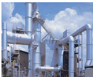
光アスコン株式会社 焼却炉
